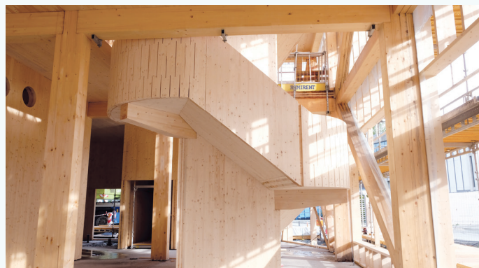
Hovudtrappa i ZEB-laboratoriet er utforma med eit ønske om å bruke minimalt med stål.
