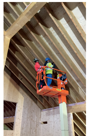
FUKT. Her nåles fuktighet i taket på bygget. Foto: SINTEF
